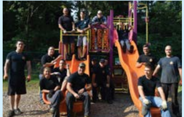
L'équipe du 12 e RBC a offert un solide coup de main pour le terrassement et l'installation de jeux.
